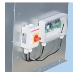
Inter de proximité monté et système de régulation câblé
